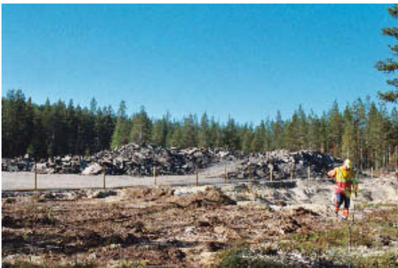
Figur 4. Lagring av tjärhaltiga massor på hårdgjord yta med uppsamling av lakvatten.
