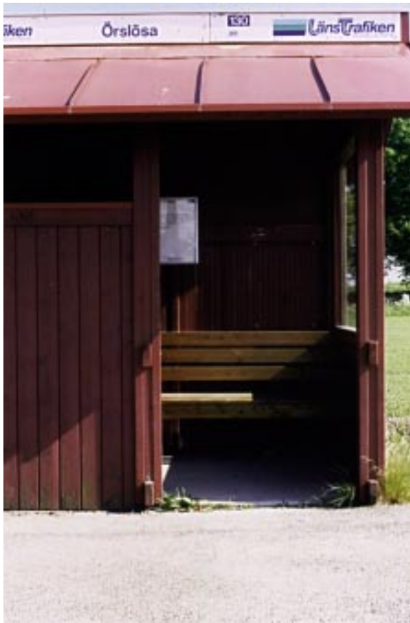
Bild 4:7 Väderskydden är utrustade med sittbänk med ryggstöd – låt vara att detta är vertikalt monterat mot den bakre väggen. Örslösa, Lidköping
