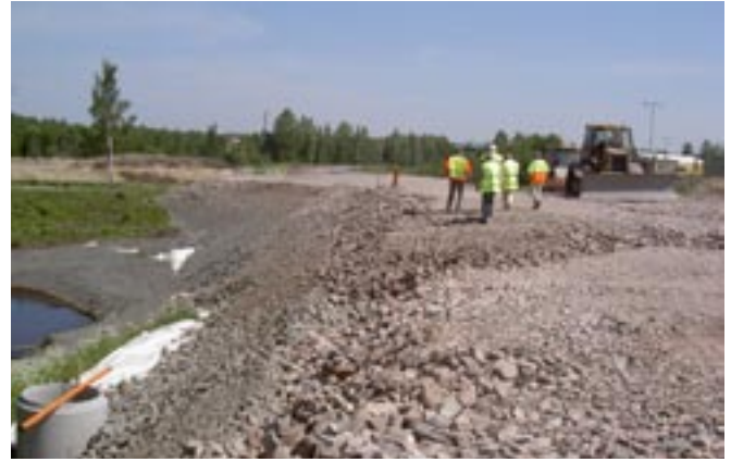
Marken under gatan Hagaleden var så dålig att massor av extra grus måste ligga där i fyra till fem månader för att trycka ihop marken så att den går att bygga en väg på.
