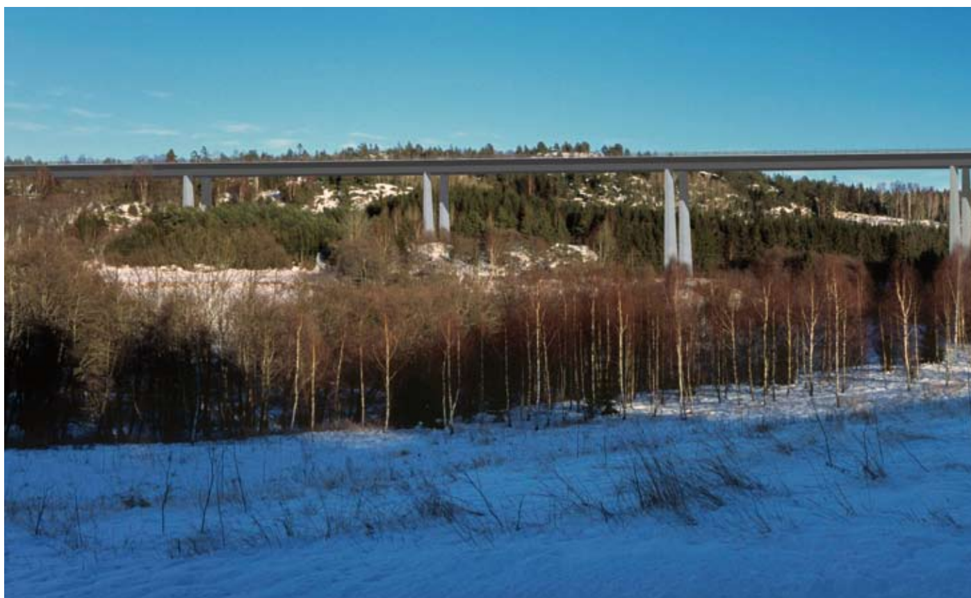
Den nya bron över Hudälven överbryggar också Bohusbanan, ett skogsparti och åkermark.
